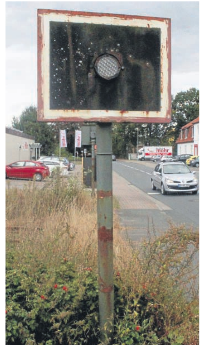
Seit Jahren außer Betrieb und verrottet: Signal am einstigen Bahnübergang in Siedenburg.
